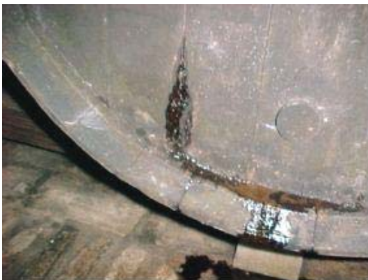
Fisura en el fondo delantero de la bota
