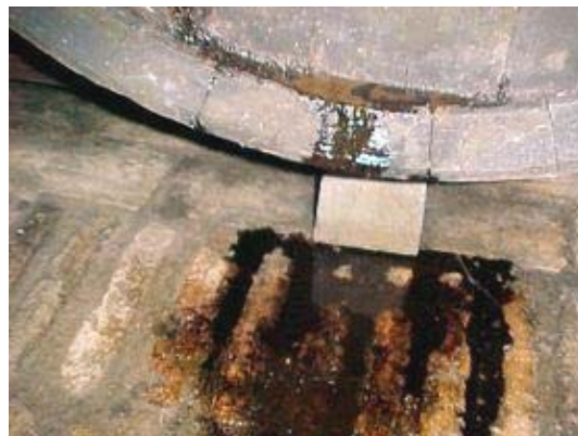
Detalle del derrame de brandy en el suelo
